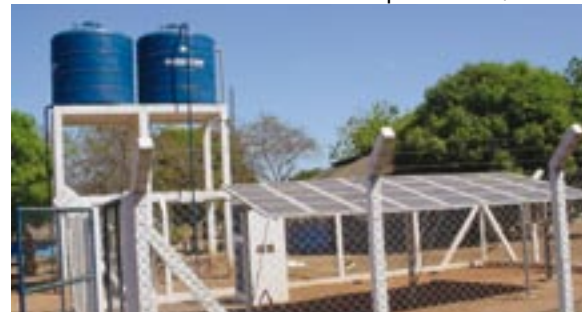
Aldeia do Alto Xingu já está recebendo água tratada
